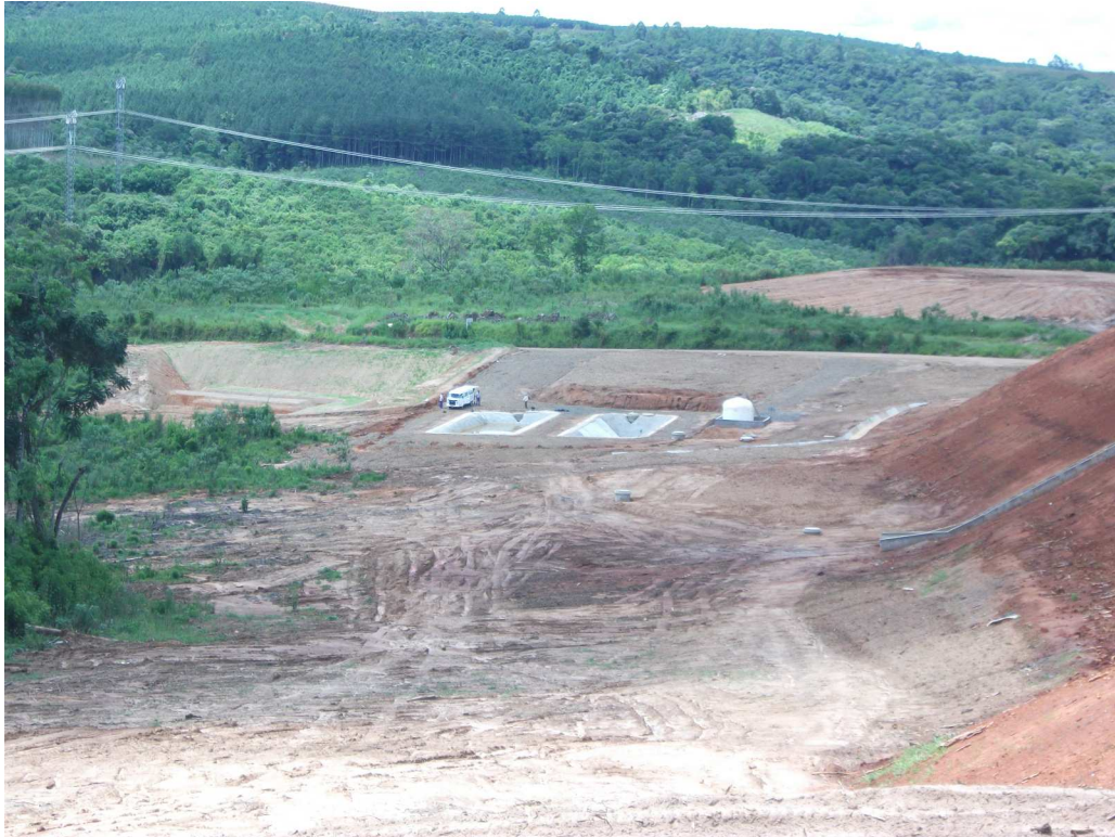
Foto 2: Vista total da estação de tratamento de efluentes.
